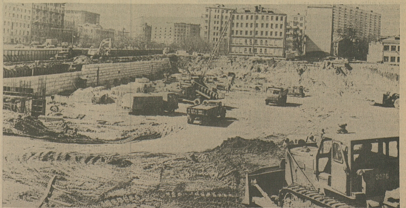
C'est sur cette excavation en plein cœur de Moscou que va être édifié prochainement le centre de presse pour les Jeux olympiques. Le bâtiment pourra accueillir quelque quatre mille journalistes en provenance du monde entier. (Keystone)
