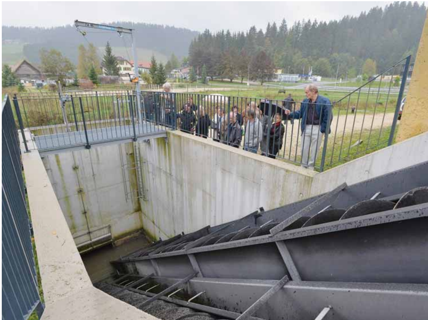
Un dégrilleur-désableur est actuellement installé en amont de l'Actiflo pour lui permettre d'absorber des eaux usées, ce qui n'était pas prévu au départ. ARCHIVES RICHARD LEUENBERGER
