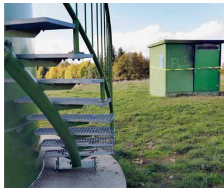
La station électrique, hors service, flanquée d'un sigle qui n'émeut pas le maire de Saint-Brais. ROGER MEIER-BIST
