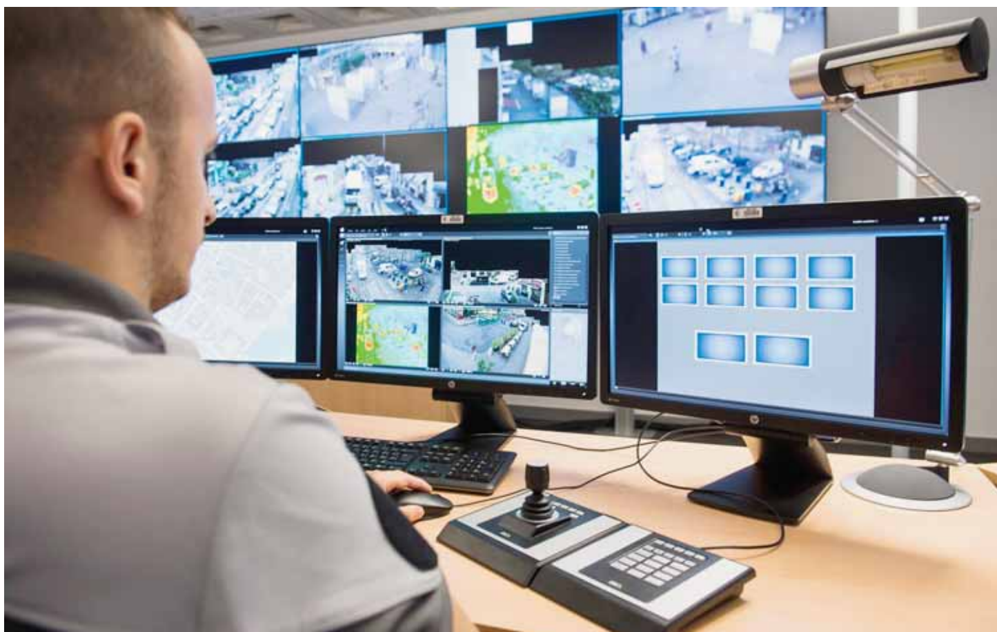
Ecrans de contrôle d'une centrale de vidéoprotection. KEYSTONE
