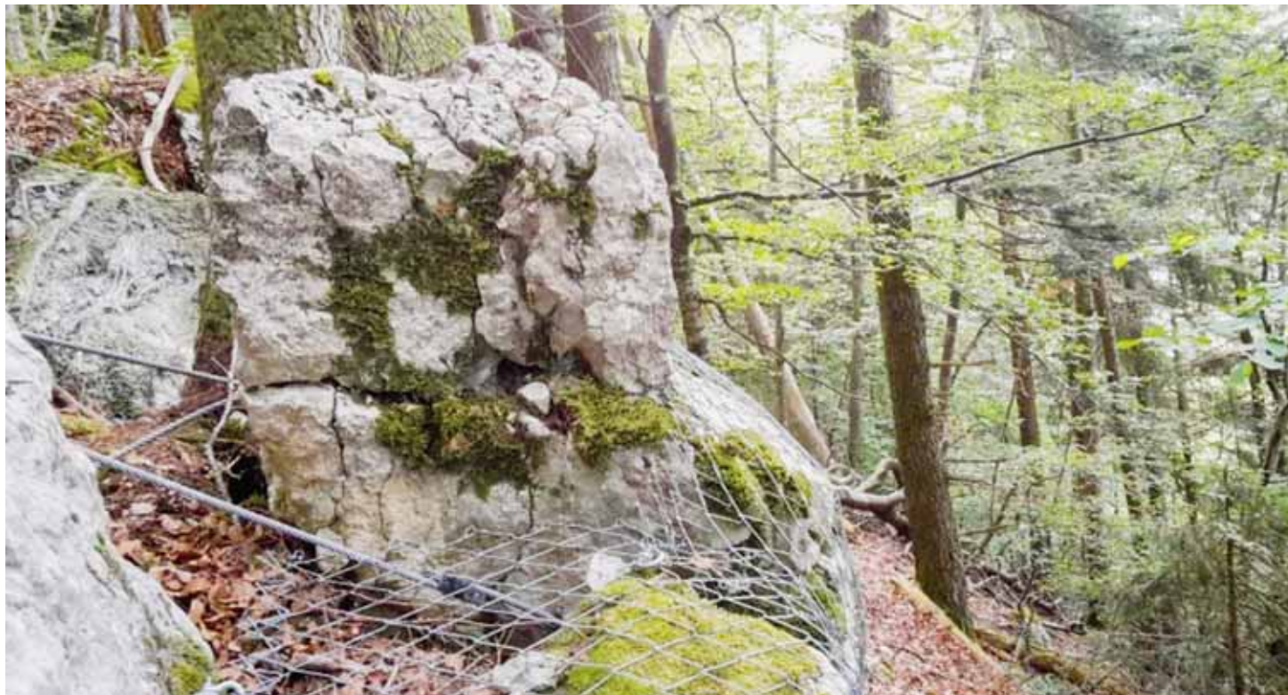
Outre un bloc qui a été éliminé par minage, un autre a été emmaillotté et arrimé à la roche stable afin d'éviter qu'il se prenne à dévaler la pente. SP
