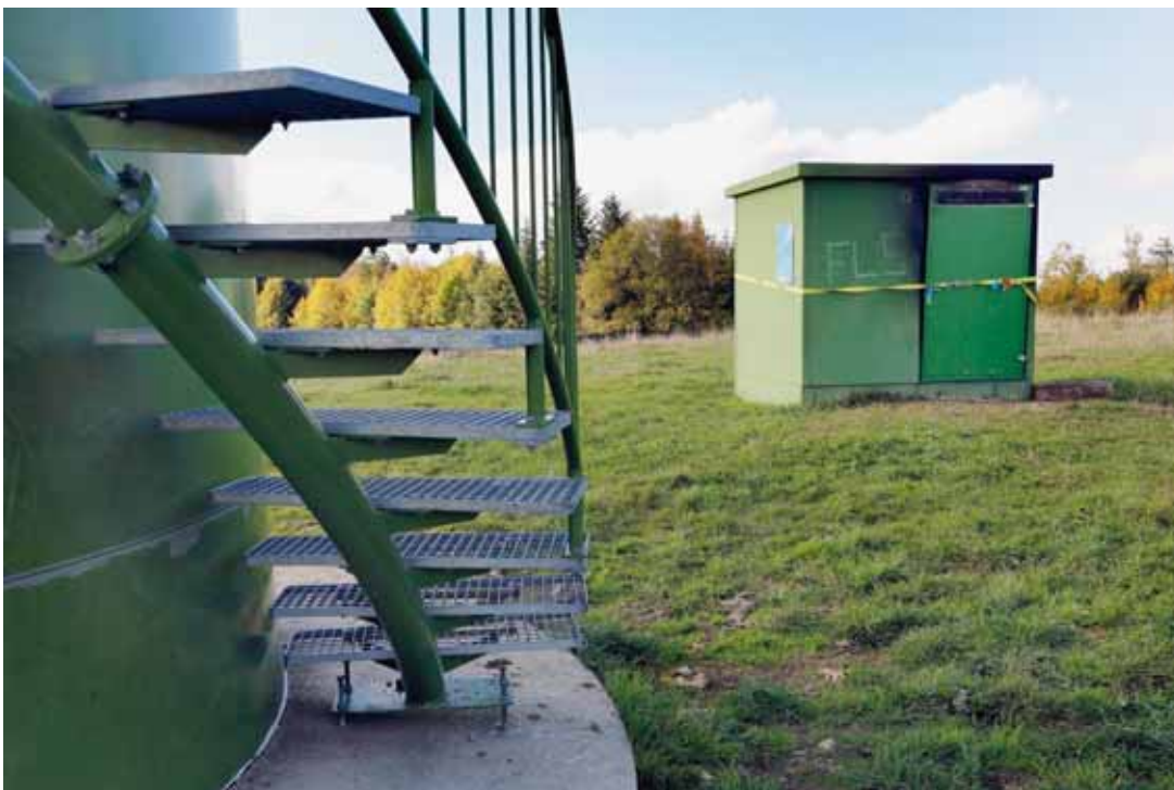
La station électrique, hors service, flanquée d'un sigle qui n'émeut pas le maire de Saint-Brais. ROGER MEIER-BIST
