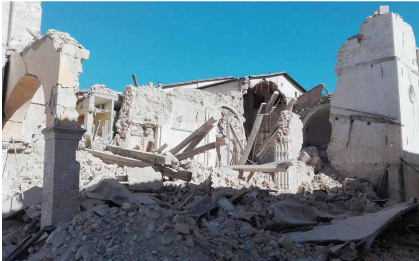
A Norcia, le toit de la basilique Saint-Benoît s'est effondré. KEYSTONE
