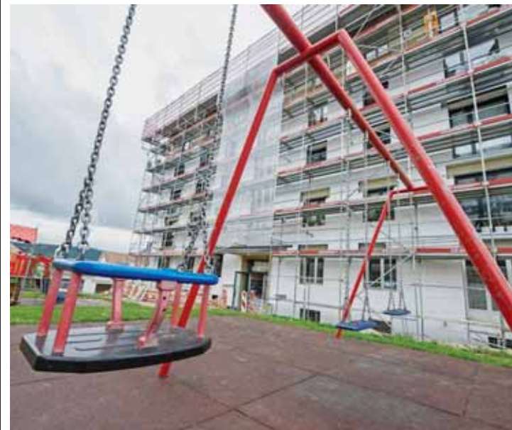
Rue du Docteur-de-Quervain, cet immeuble en chantier accueille deux classes de 1ère et 2e Harmos. DAVID MARCHON
