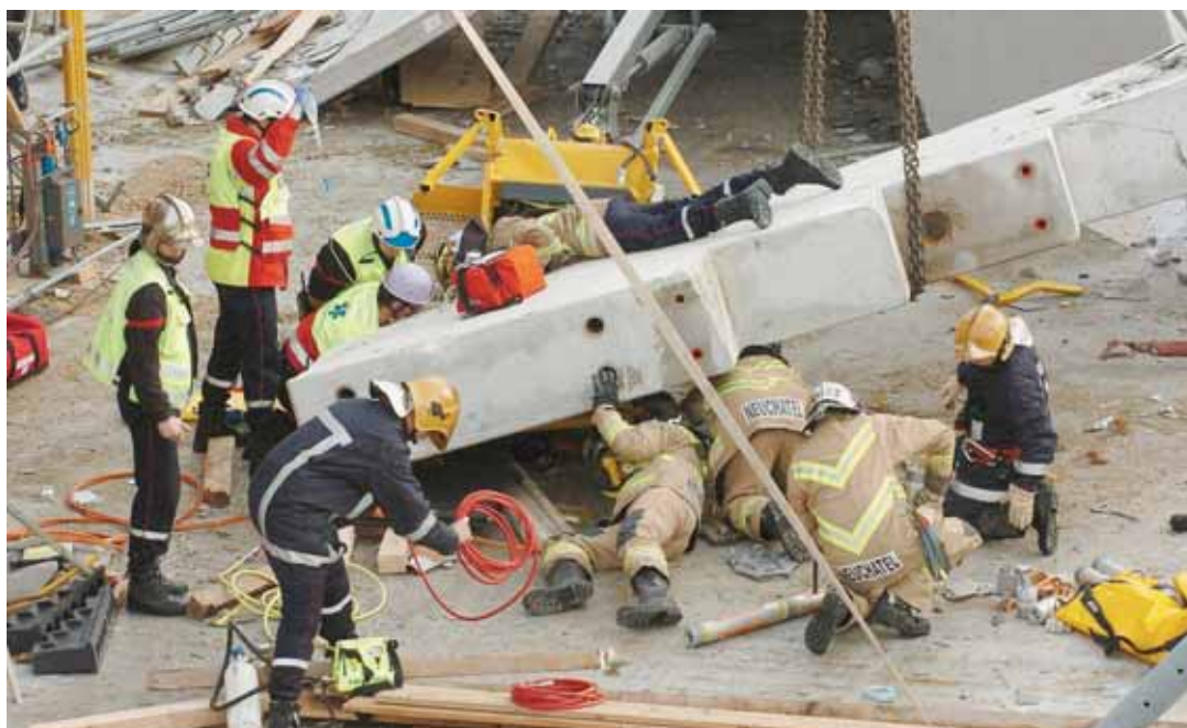
Le 6 décembre 2005, le malheureux ouvrier se faisait écraser par une pièce en béton pesant 15 tonnes. Il avait dû être amputé de son avant-bras sur place avant d'être hospitalisé. ARCHIVES RICHARD LEUENBERGER
