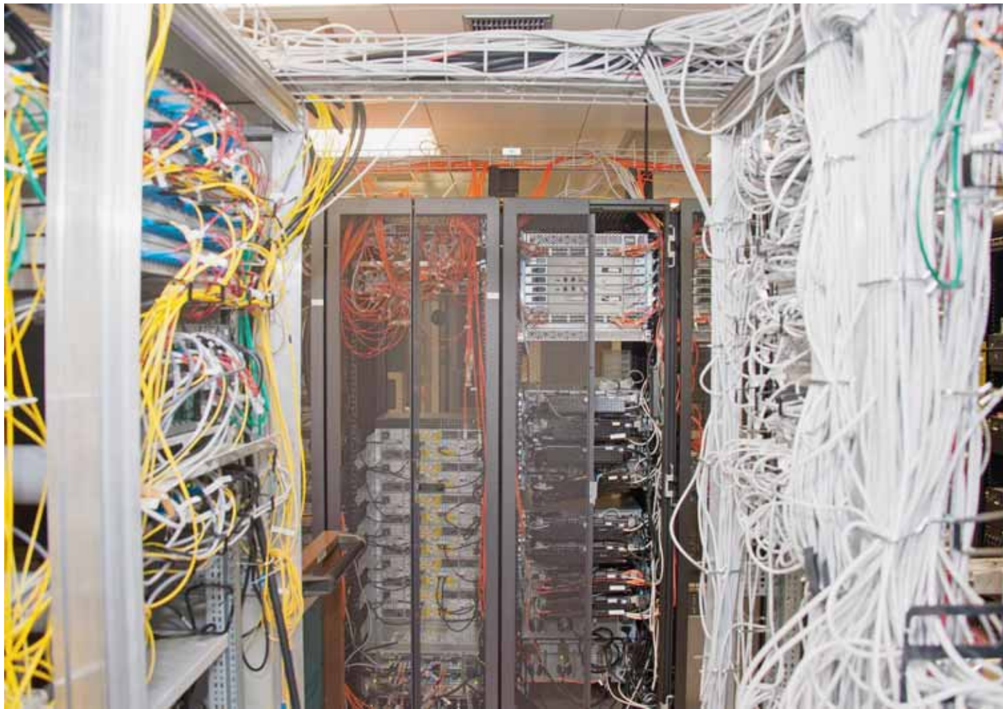
Une vue partielle de la «salle machines» de Neuchâtel du Service informatique de l'entité neuchâteloise. DAVID MARCHON
