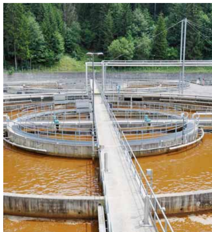
Un crédit d'engagement d'un million de francs concerne la station d'épuration. ARCHIVES RICHARD LEUENBERGER
