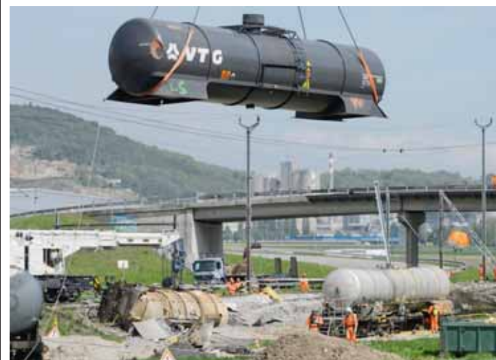
La citerne d'un wagon est évacuée par une grue, à Daillens. Le trafic ferroviaire sera perturbé encore durant plusieurs jours. KEYSTONE
