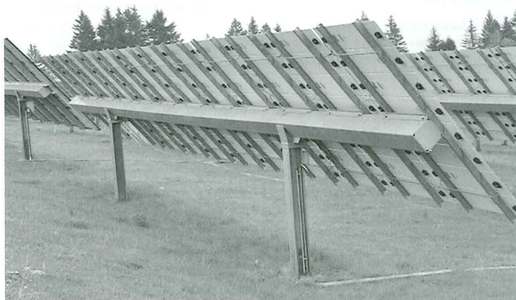
Panneaux solaires au Mont-Soleil. Photo Mokry
