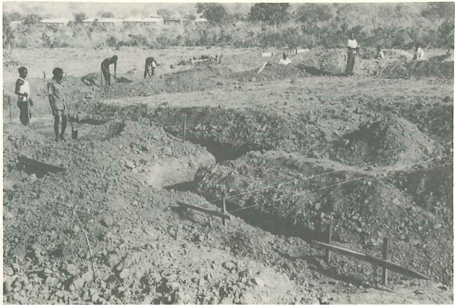
Travaux de terrassement et de fondation pour l'église St Thomas à Lilongwe.
