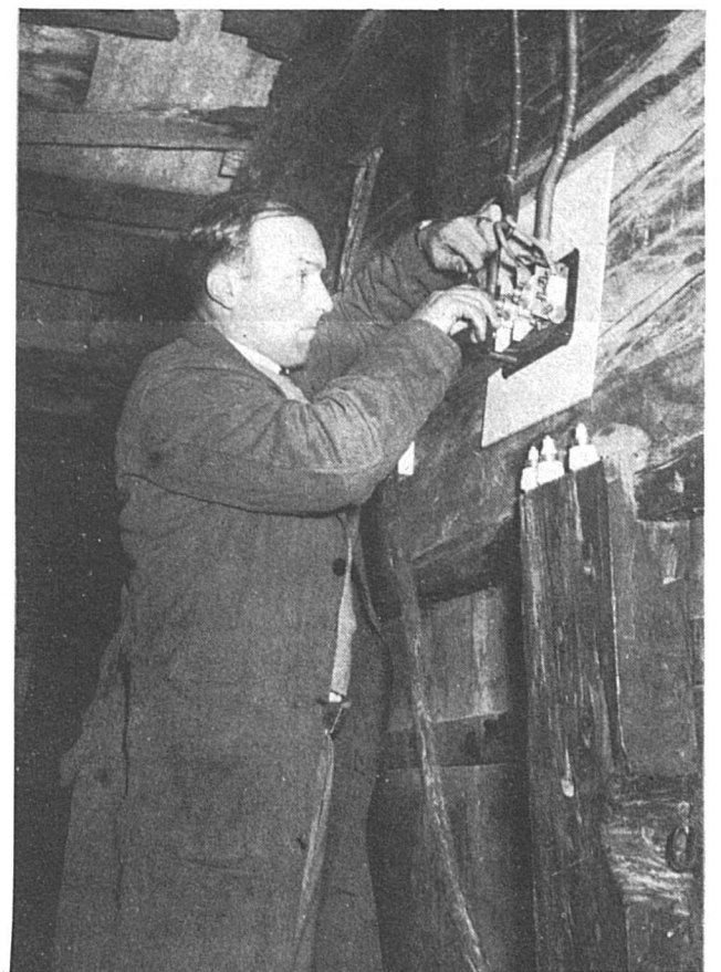
M. A. Bonvin, qui se dévoue sans compter pour la cause de la radiographie et opère dans tout le Valais, doit connaître tous les métiers! Le voici installant le courant dans les combles de l'école.
