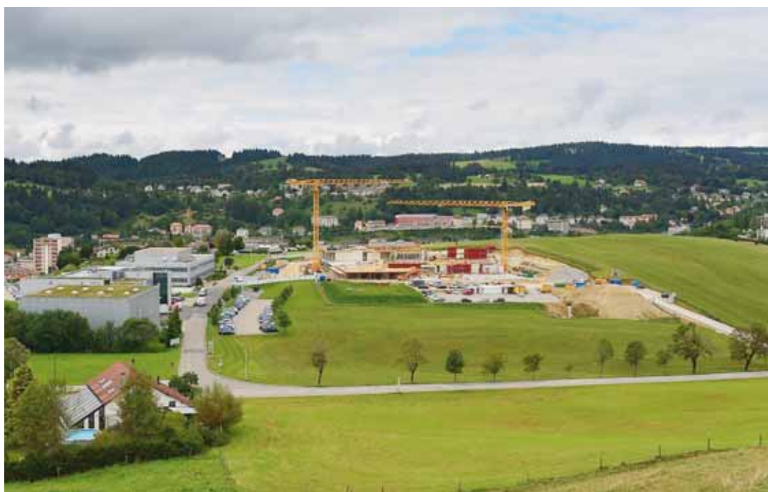
La parcelle privée convoitée par la Ville se trouve à l'est et au nord des zones occupées par Johnson &amp; Johnson (ex-Intermedics) tout à gauche, et la future usine Cartier, actuellement en travaux. Photo Richard Leuenberger
