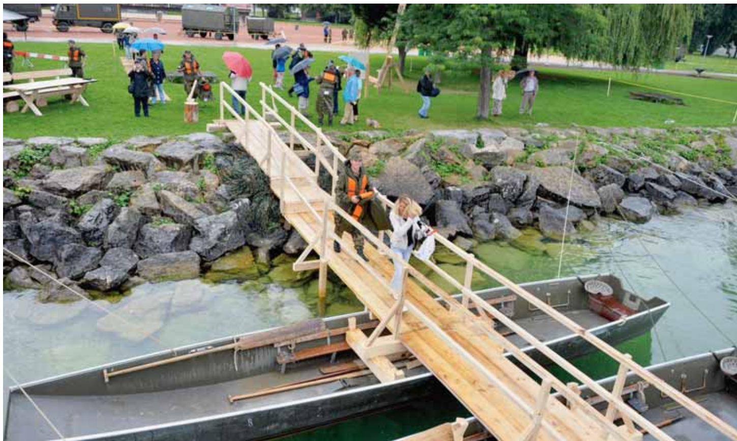
Professionnels du bâtiment dans le civil, les soldats ont bâti des ponts et passerelles sous les yeux du public.
