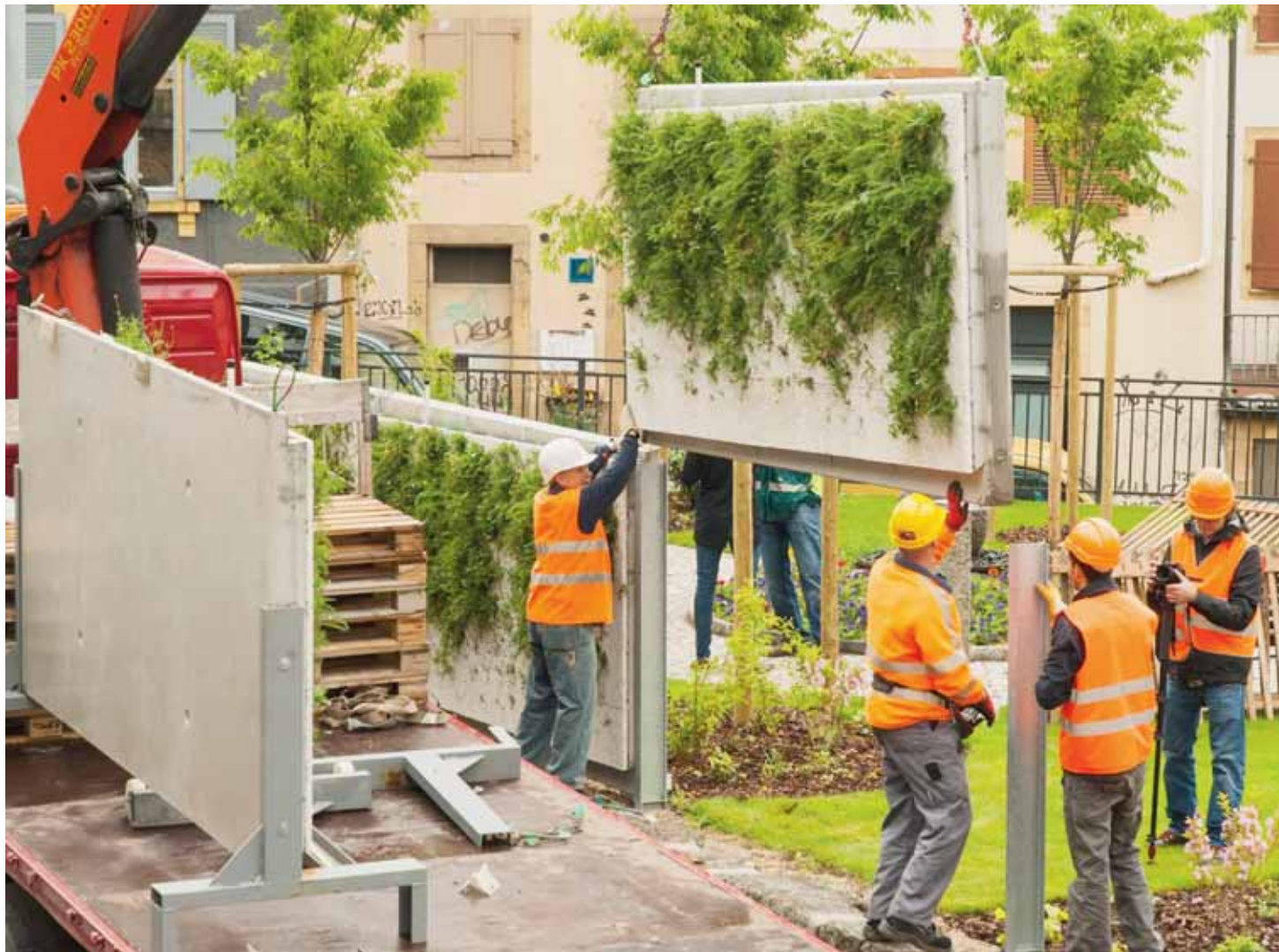
Les dalles végétalisées composant le mur ont été installées à l'aide d'un camion-grue par une entreprise spécialisée. NICOLAS HEINIGER
