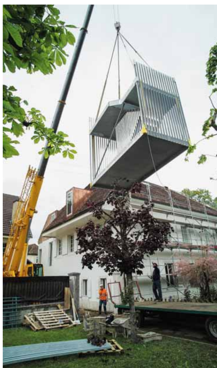
Les près de 3500 kg de la nouvelle sortie de secours ont pris la voie des airs pour se retrouver entre les deux bâtiments. Du travail d'orfèvre.
