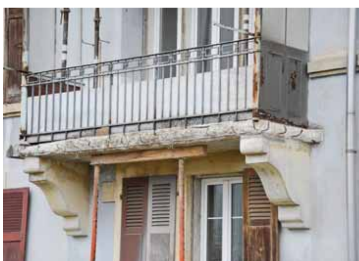
Des immeubles vénérables qui tombent en ruine... RICHARD LEUENBERGER
