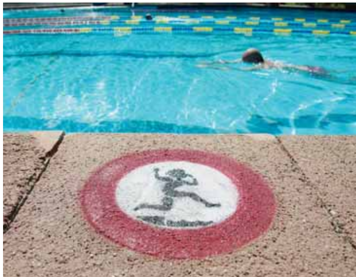
Il n'est pas rare que l'on se blesse les pieds à cause des dalles disjointes.
