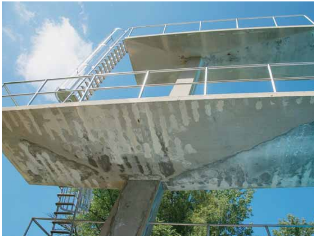
Petit constat hier de l'état des installations de la piscine des Mèlèzes. Même le plongeur, toujours élégant, marque des signes d'usure qui menace à terme sa stabilité. DAVID MARCHON
