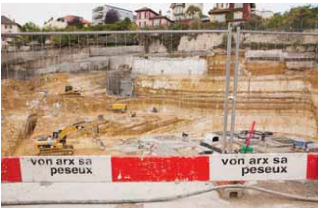
2011 Un gros trou C'est bien ici que va s'élever, sur sept étages, dont deux en sous-sol, le bâtiment offrant 17 000 mètres carrés de surface utile. La pose de la première pierre, en octobre, donne le coup d'envoi d'un chantier de construction qui durera deux ans.
