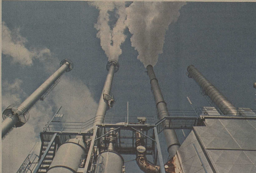
Les quatre cheminées des fours d'incinération. Un mode de destruction des déchets conforme aux exigences écologiques, grâce à l'existence de filtres et de laveurs complexes.
