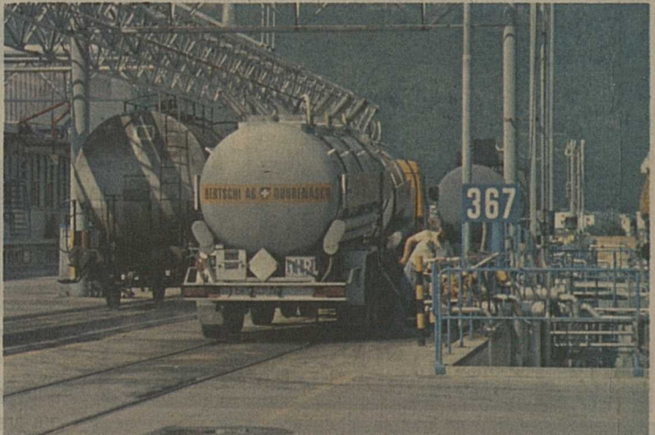
Dans une avenue de l'usine: camions et wagons-citernes déchargent les matières premières dans des réservoirs logés, par mesure de sécurité, dans des fosses en béton.
