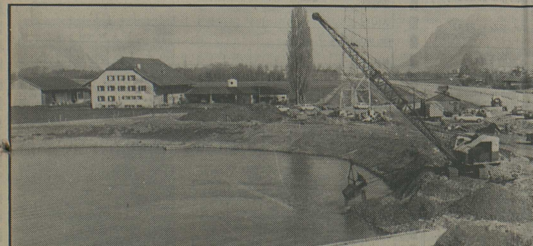
Ce bassin de rétention que l'on remarque à Saint-Triphon contient 30 000 m 3 d'eaux usées. Les eaux récupérées le long de l'autoroute sont dirigées dans ce genre de bassin, précédé d'un déshuileur. Cet ouvrage immergé fait office de récupérateur d'hydrocarbures éventuels.
