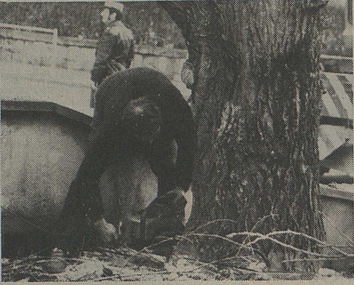
Le tronçonnage de la base d'un peuplier qui est maintenu droit par le bras de la grue.
