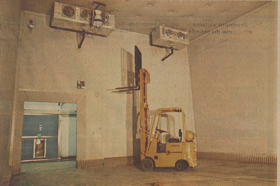
Tous les secteurs de la vie rurale seront représentés. Notamment le problème de l'entreposage des fruits et légumes avec, par exemple, la participation d'une entreprise telle que celle établie à Martigny et appartenant à M. Silvio Mosch, entreprise spécialisée dans l'étanchéité des chambres de refroidissement, dont nous voyons ici une des réalisations à Ecône.
