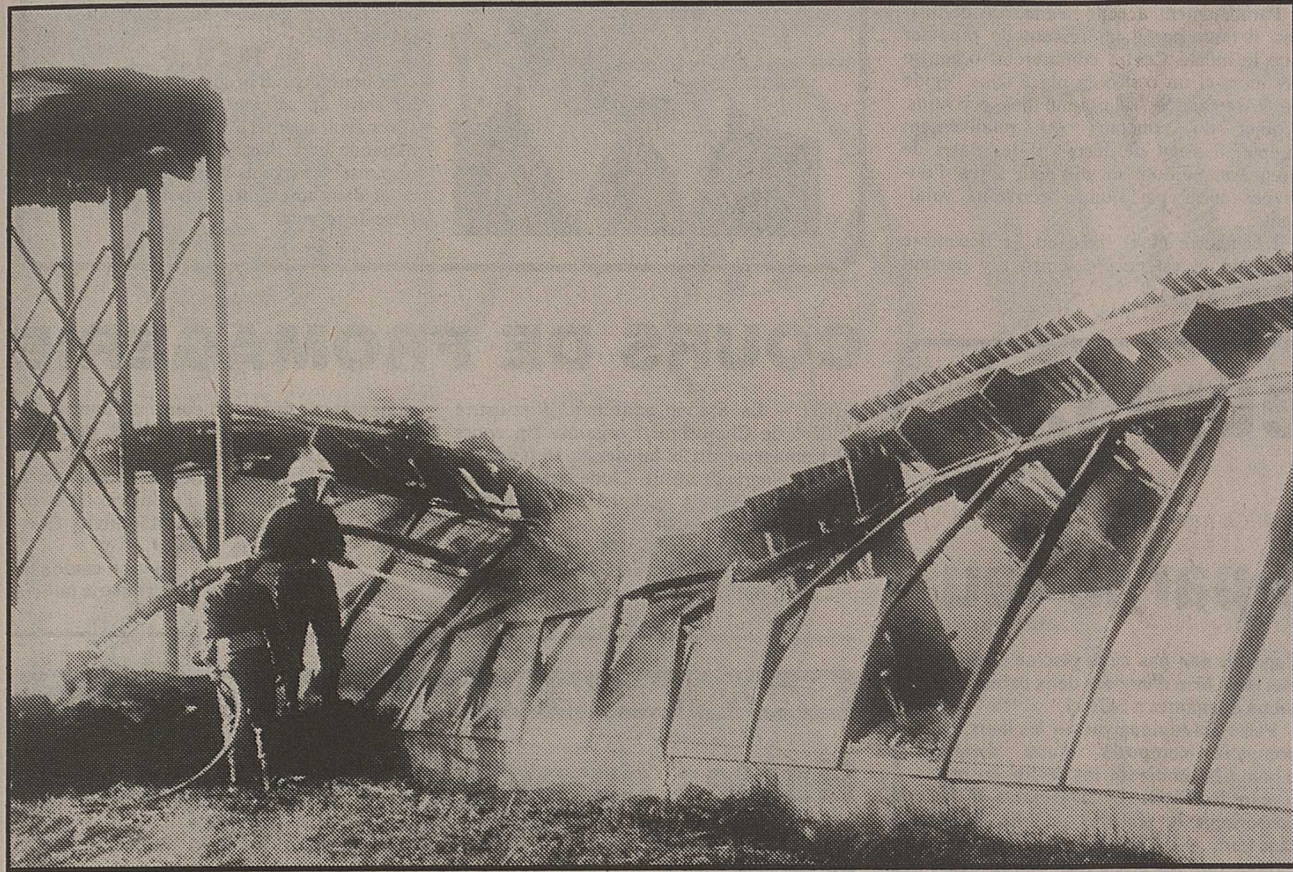
Le pavillon abritant les coquelets a été complètement anéanti.
