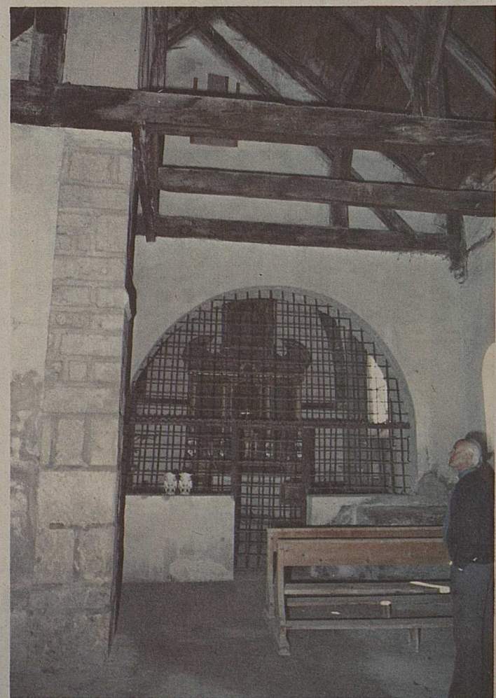
Le curé Auguste Pont nous a fait visiter l'intérieur: le plafond n'existe plus, la poutraison est érodée, l'autel a été à maintes reprises dépouillé... Photos NF.
