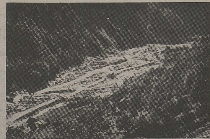
Vue de la vallée Vergeletto entièrement recouverte de déblais alluvionnaires, et l'on remarque au milieu le tracé de la nouvelle route que la troupe construit.
