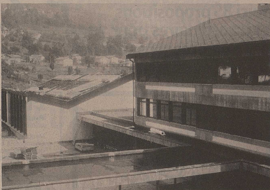
Voici le bâtiment de l'école primaire prolongé de la future grande halle polyvalente.
