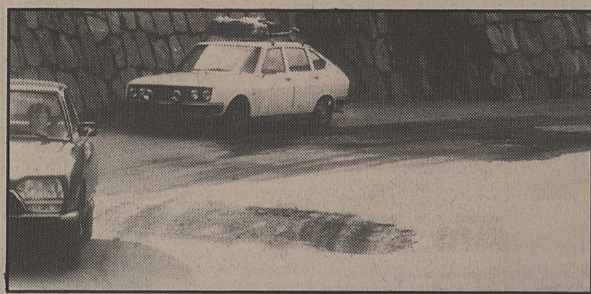
Comme le montre notre photo, même de modestes travaux d'entretien ne sont pas entrepris.
