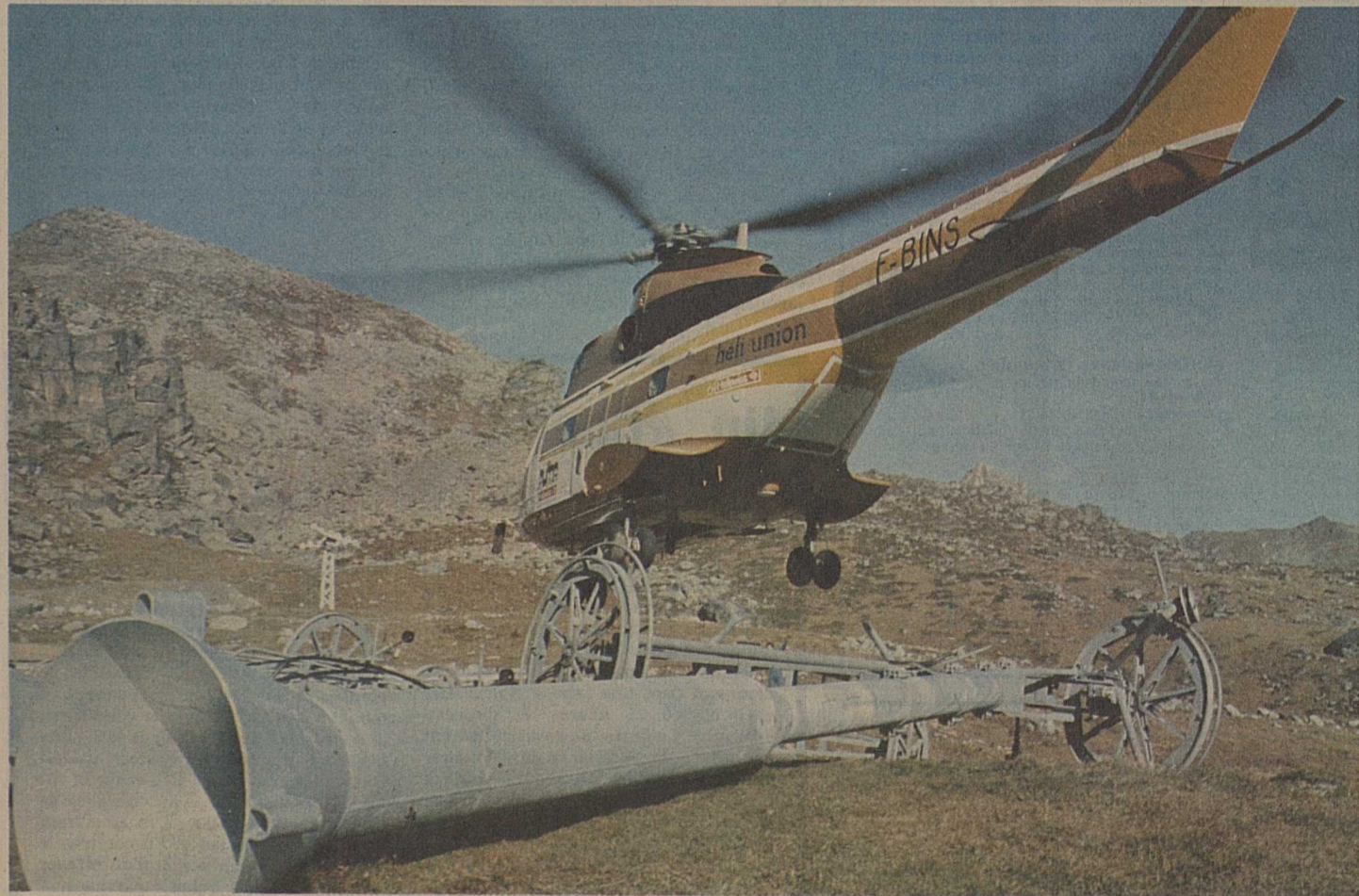
Le domaine skiable de la station de Grimentz va s'accroître dans de notables proportions avec l'aménagement, sur les hauts du village, du nouveau téléski de Lona. Dans le cadre de cette opération, on a procédé, hier, à la pose des pylônes. Un travail délicat s'il en est, et qui nécessita l'intervention d'un imposant hélicoptère
