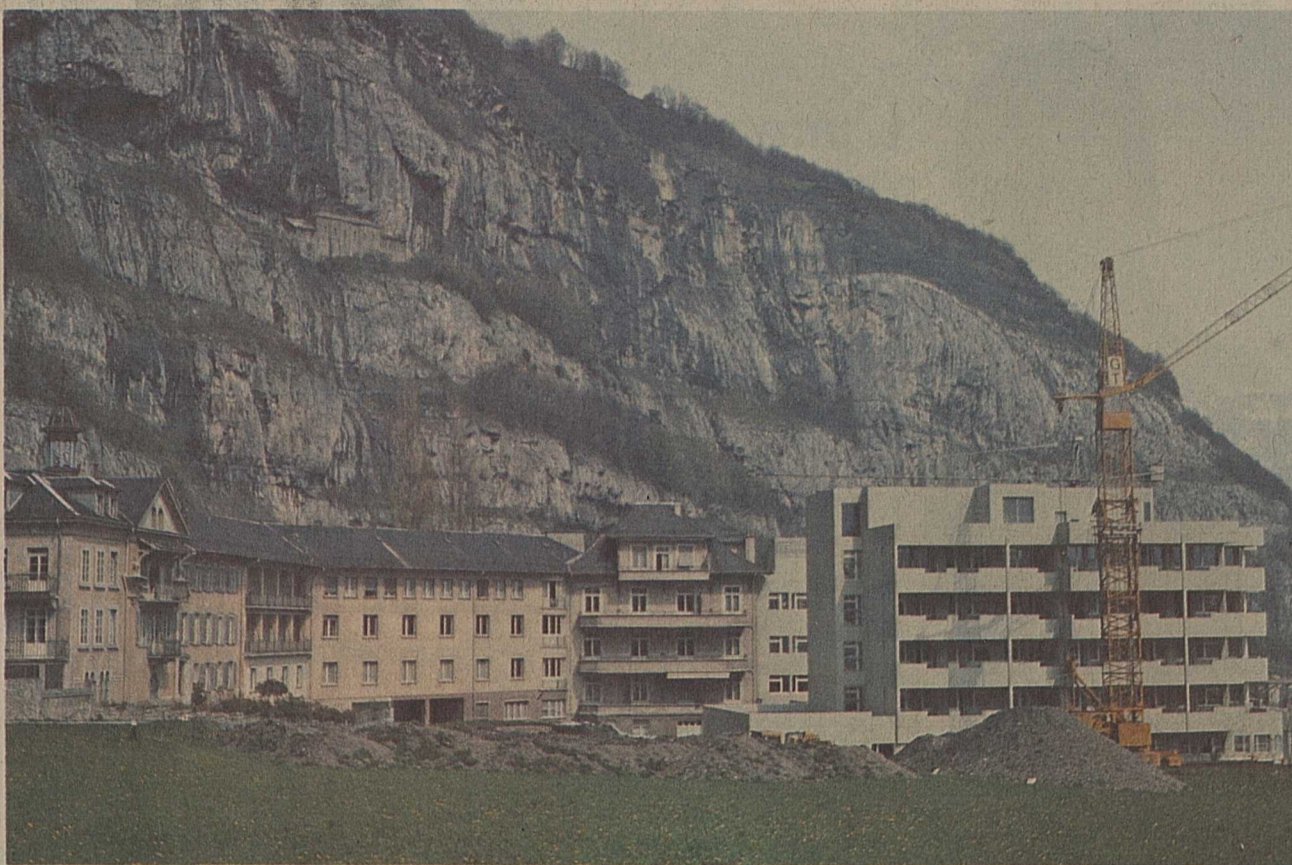
Une vue générale de la clinique prise du côté sud avec tout à gauche, l'aile qui est appelée à disparaître.
