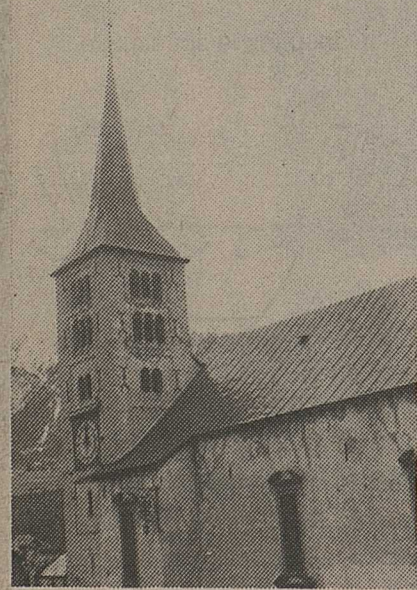
L'église de Naters, dédiée à saint Maurice: son état nécessite une urgente restauration.
