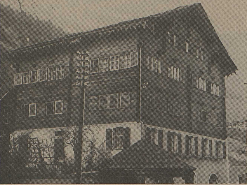
L'ancienne maison patricienne de Mörel, devenue propriété de la paroisse. Pour l'heure, le conseil paroissial, prudent, envisage tout simplement de réparer son toit qui menace de s'écrouler.
