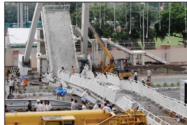
L'effondrement du pont complique une situation déjà grave. AP
