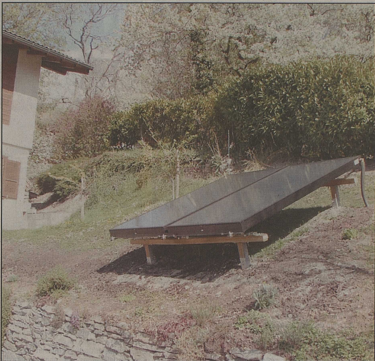
Pour chauffer l'eau sanitaire d'une famille de quatre personnes, 6 mètres carrés de panneaux solaires suffisent amplement. J. ANZÉVUI
