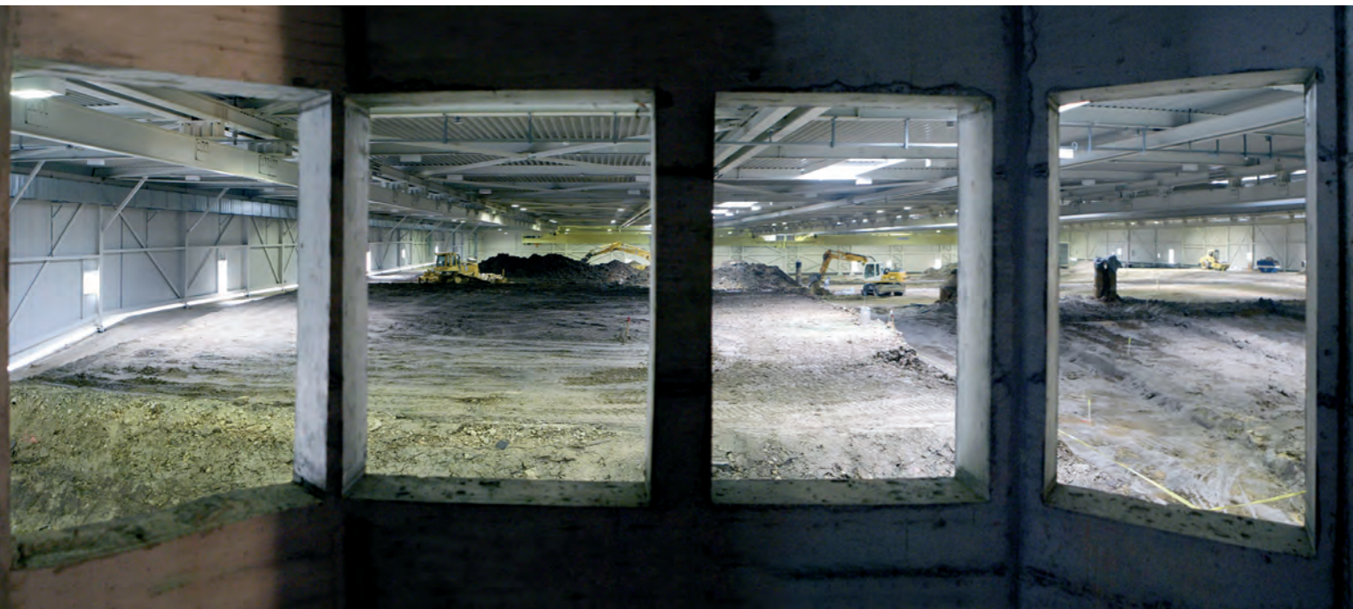
Vue du futur poste de commande sur l'intérieur de la halle d'excavation.
