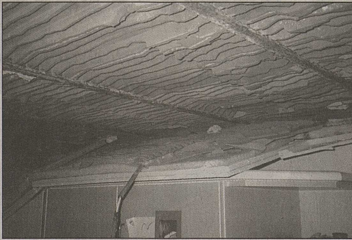
Les modes de construction de l'époque laissent apparaître aujourd'hui de gros dégâts dans certains appartements.
