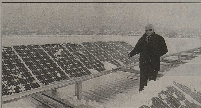
A la minoterie Stadtmühle, on a fait monter 232 m 2 de cellules solaires sur les façades des silos et sur le toit.
