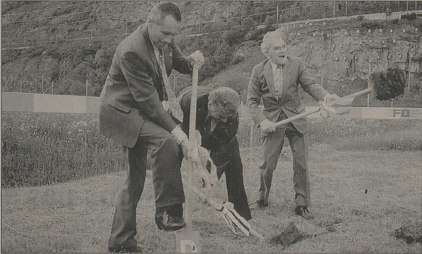
Premiers coups de pelle pour le nouveau dépôt du FO par MM. Carlo Dittli, Alfred Gasser et Bernard Bornet.
