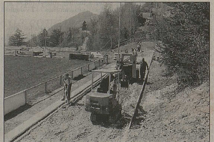
La piste d'athlétisme en cours de construction par les hommes de la PCI. nf
