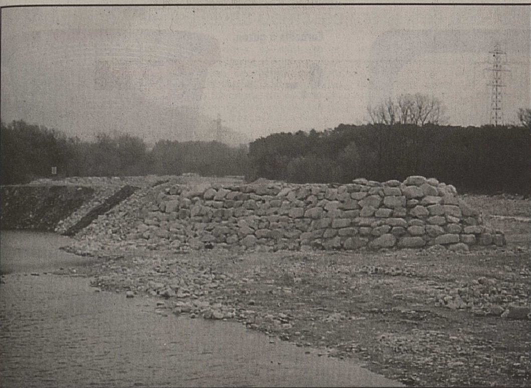
Des digues bétonnées dans leur partie inférieure ont surgi au milieu du lit du Rhône.
