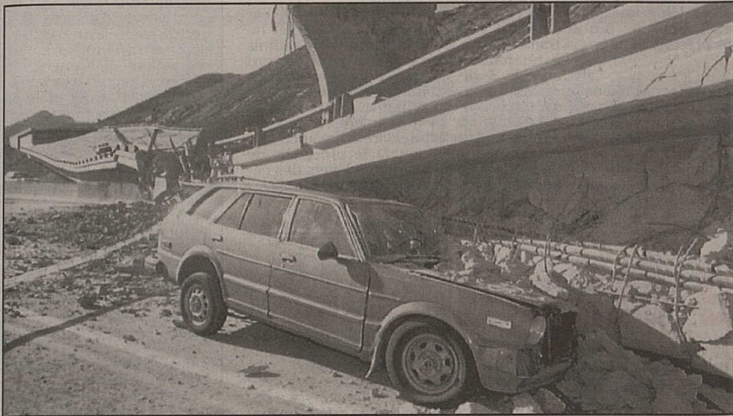
Dans la région de Sylmar, au nord de Los Angeles, l'autoroute s'est écrasée sur la route nationale. Un motocycliste de la police y a trouvé la mort: au guidon de sa moto, il a fait une chute de huit mètres.
