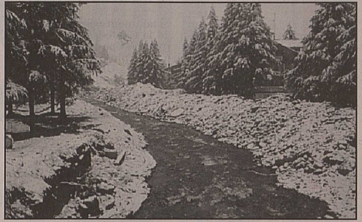
Le lit de la Viège, à Saas-Allmagell, ravagé par les eaux en furie du 24 septembre dernier.
