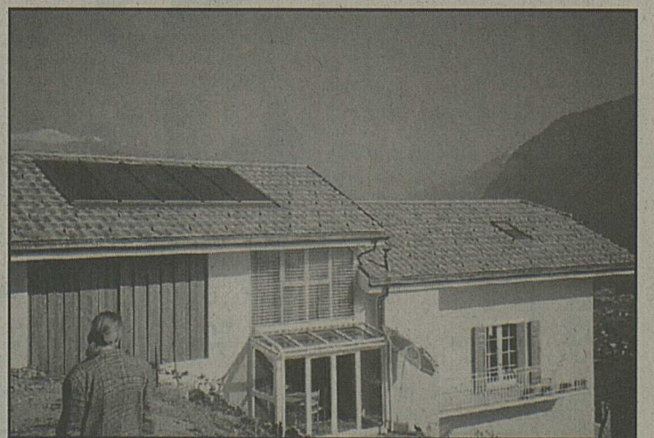
Installation solaire dans une villa à Darnona pour la production d'eau chaude sanitaire et un appoint au chauffage.
