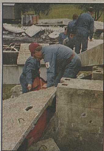
Accident de chantier: un travail difficile.
