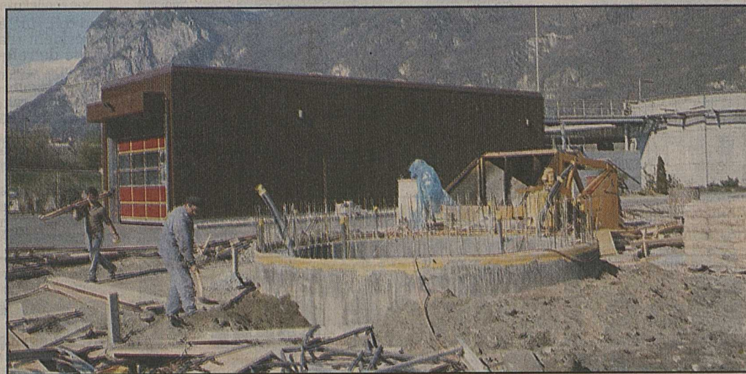
La construction de la step N° 2: Orgamol aurait pu s'en passer. Elle l'a réalisée pour montrer son souci à l'égard de l'environnement.
