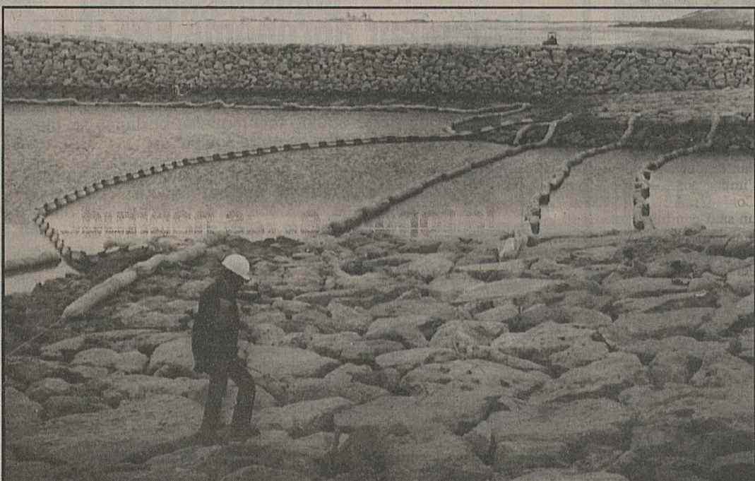
A l'entrée du canal d'une usine de dessalement on a installé des barrages pour retenir le pétrole.
