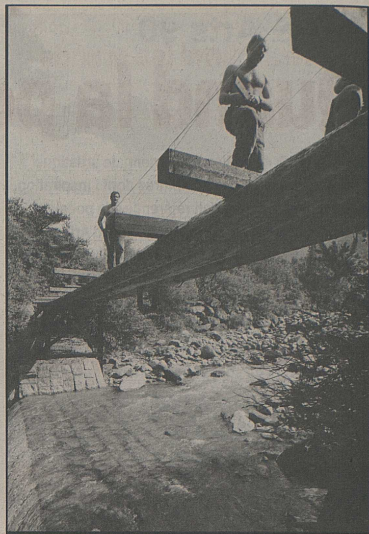
Passerelle en bois de 25 mètres de long sur le Saint-Barthélémy, près de Saint-Maurice.
