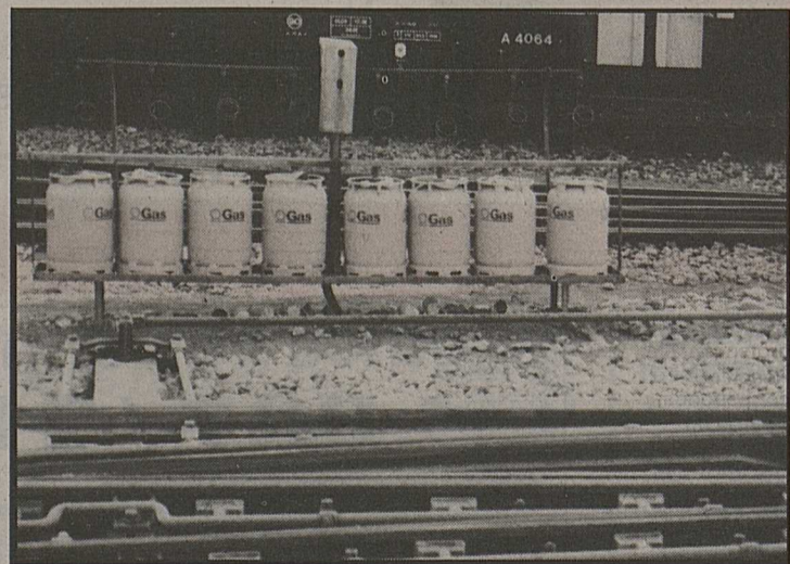
Les installations de chauffage de la gare BVZ-FOB.
